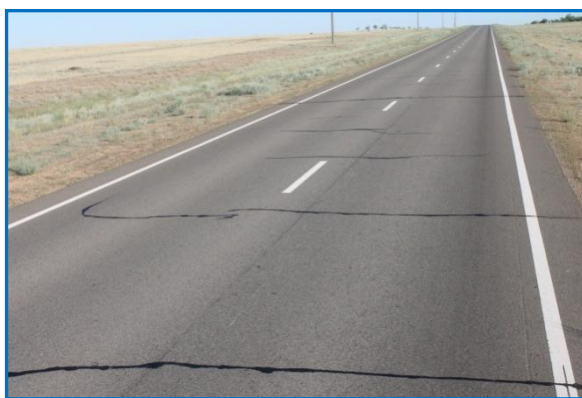
Рисунок 1. Низкотемпературное растрескивание асфальтобетонного покрытия автомобильной дороги
