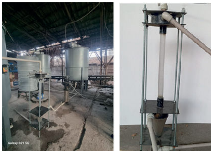
а – общий вид установки на площадке; б – конструкция гидроциклона на каркасной раме с прозрачной кварцевой цилиндрической трубкой.
