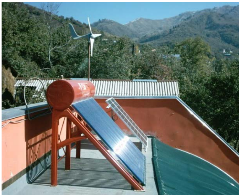
Фото 1 – Элементы использования солнечной и ветровой энергии на опытной теплице
