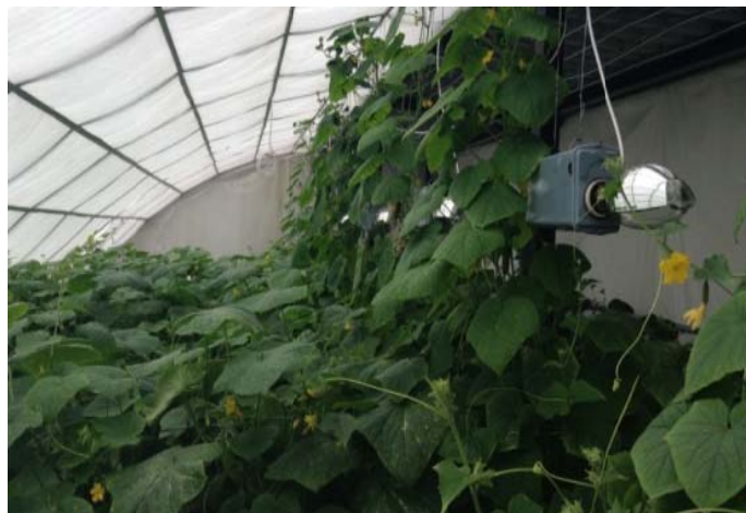
Фото 7 – Изоляция прозрачного ограждения опытной теплицы с внутренней стороны (на фото видны лампы для искусственного освещения)
